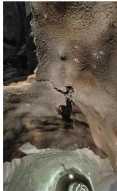
Fotografía 2: Grietas y descuelgue de sostenimiento y parte de material del macizo en zona contigua
