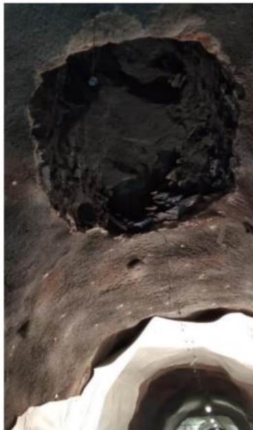
Fotografía 1: Desprendimiento en clave
